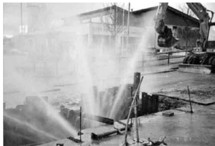
Wasserrohrbruch in der Morgenstrasse
