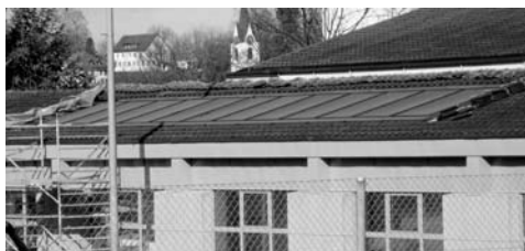
Solaranlage auf dem Dach der MZA Breite
